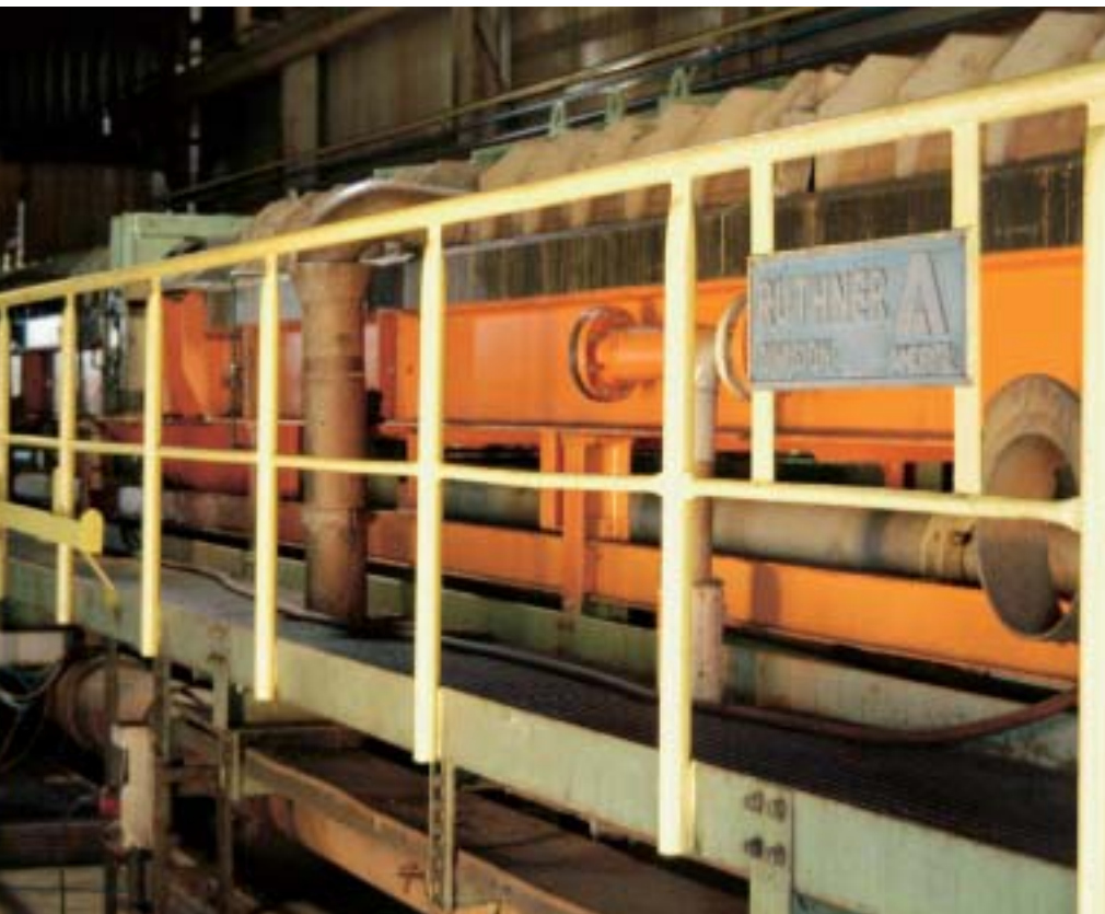
Durch die Modifizierung der Schubbeizanlage wurde die Warmbandentzunderung von Rost-, Säure- und Hitzebeständigen Stählen ermöglicht. The push feed pickling plant has been modified to enable hot strip descaling of stainless and heat resisting hot and cold rolled strip.
